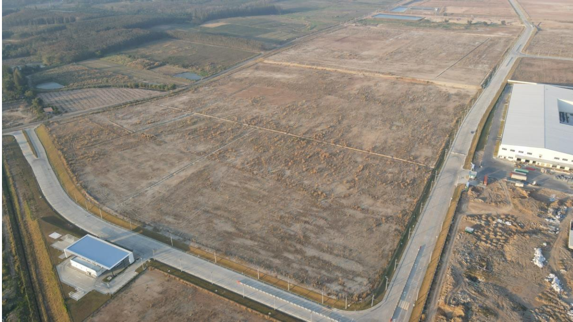
Lotus Bakeries' nieuwe productiesite in de Chonburi provincie, Eastern Economic Corridor, Thailand.
